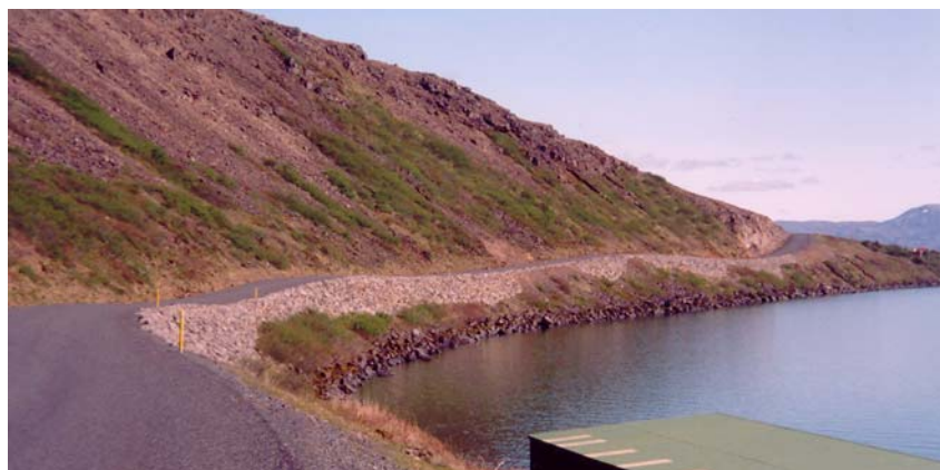
Mynd 18: Vegflái styrktur með stórgrýti á Grafningsvegi við Þingvallavatn. Hér hefði styrkur jarðvegur getað komið til greina.
