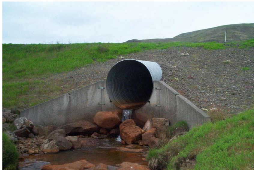
Mynd 20: Vegræsi í Hvalfirði. Notast mætti við styrktan jarðveg í stað steypu veggjanna.
